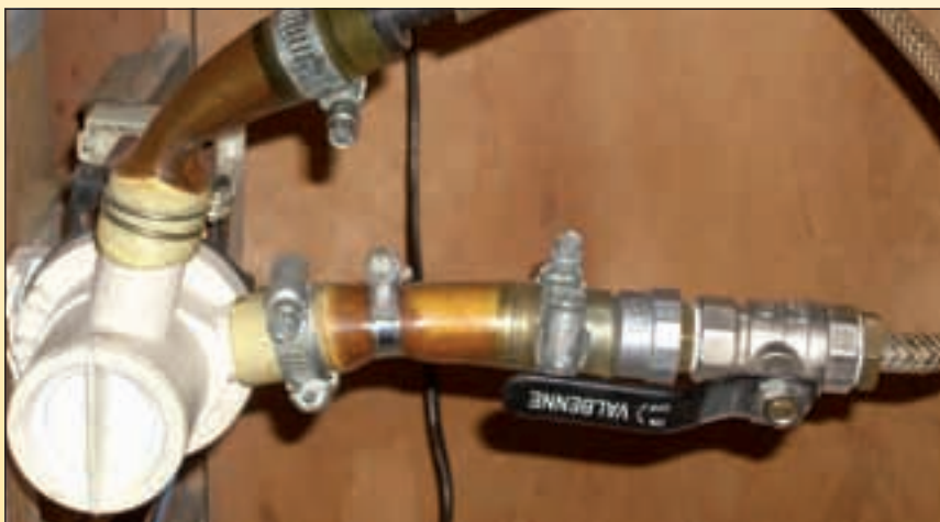
Bombita para recirculado durante el macerado
