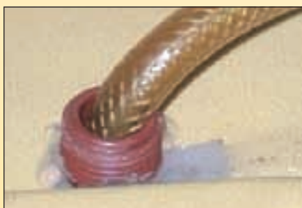
Ingreso de la manguera proveniente de la Bombita
